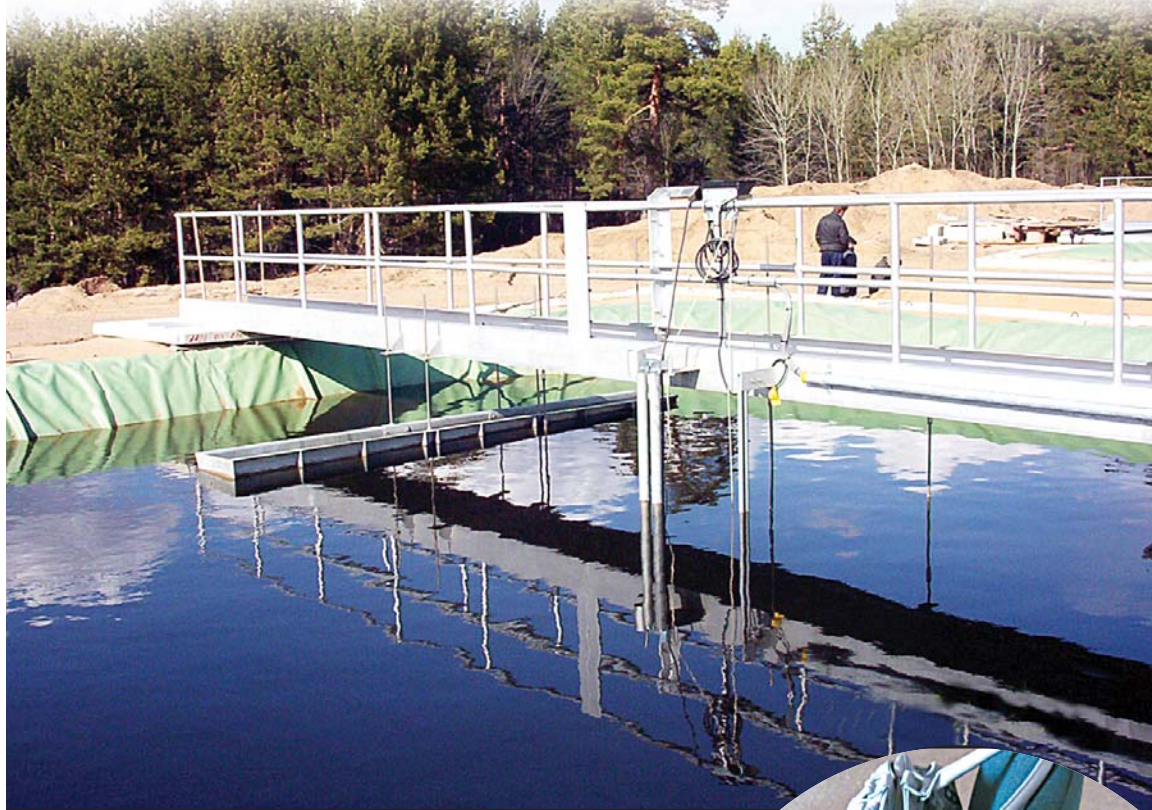
Современные канализационные очистные сооружения в поселке Волжский стали первым объектом компании «Самэнви́ро».
